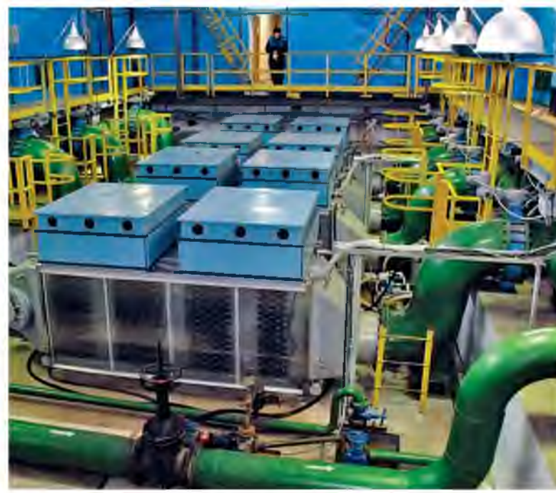
Современное и надёжное оборудование позволяет цеху №15 обеспечивать качество очистки сточных вод
